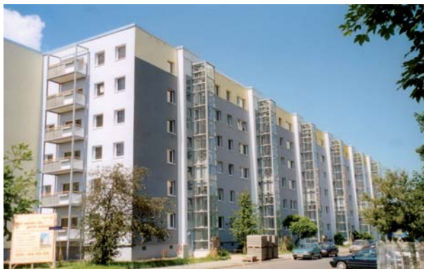
Verbesserte Wohnbedingungen durch Anbau von Balkonen und von Aufzügen im Bestand (Foto: Brigitte Dittrich)
